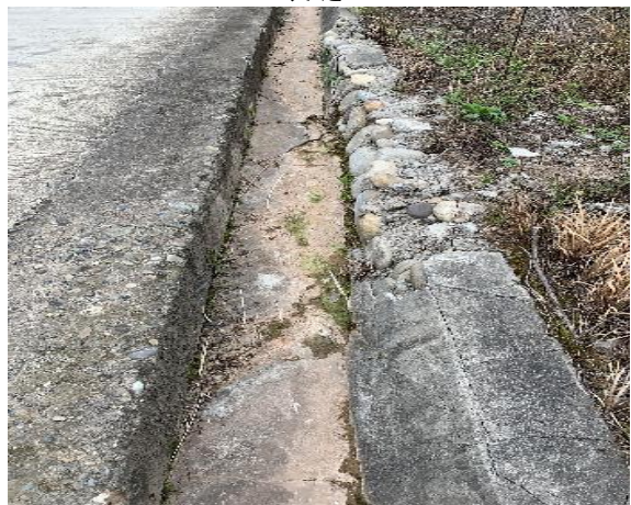
现状既有边沟损坏
