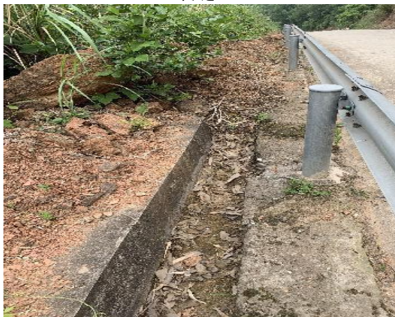
现状既有边沟堵塞
